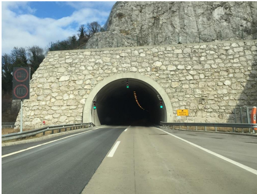
Slika 1: Pred predorom Kastelec je betonsko vozišče na voznem pasu, v predoru pa tudi na prehitevalnem pasu.
